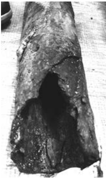
写真5 築32年の鉄管（排水用）の漏水事故で、管が腐食して漏水している様子
