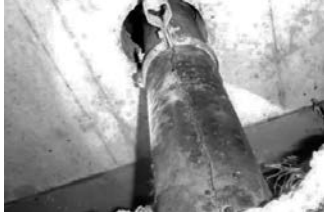
写真4 築30年のマンションにおける排水用铸铁管（横引き主管）の亀裂
