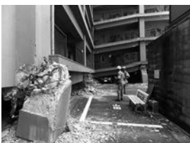
熊本地震での被害事例
