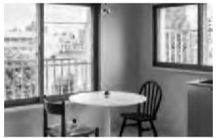
防音や結露防止のため内窓を設置。遮熱や断熱のため断熱塗料を壁面に使用
