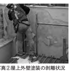
写真2 屋上外壁塗装の剥離状況
