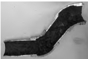
④抜管後縦割りにした台所排水用鋼管内部
