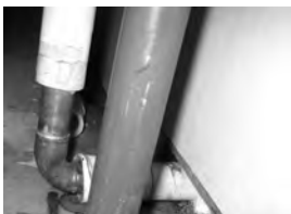
③銅管ピンホール漏水(奥の配管で発生)
