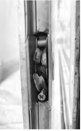
写真3 破損した戸車
