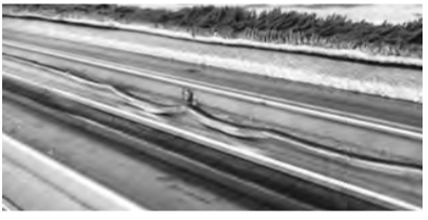
写真4 損傷を受けたレール
