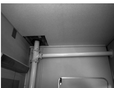
浴室洗面系統排水管
