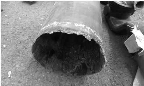
36年使用した排水管・塗装鋼管(ELP)の鉄部消失状況
