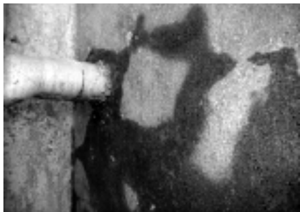
写真3：モルタル塗り層内に広がる漏水
