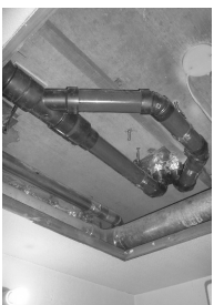
洗面所天井に更新された上階の配水管
