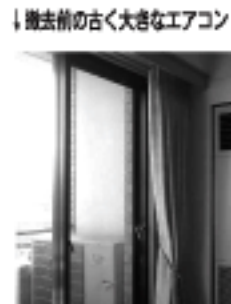
撤去前の古く大きなエアコン
