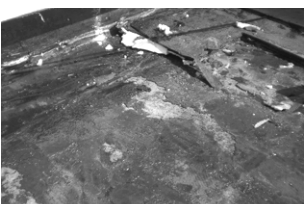
既存防水層裏に雨水の浸透
