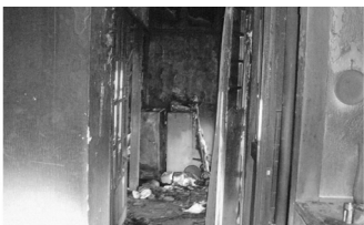
全焼住戸の室内
